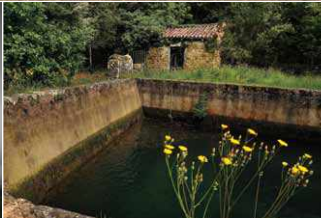
Depósito regulador de Urzulo.
